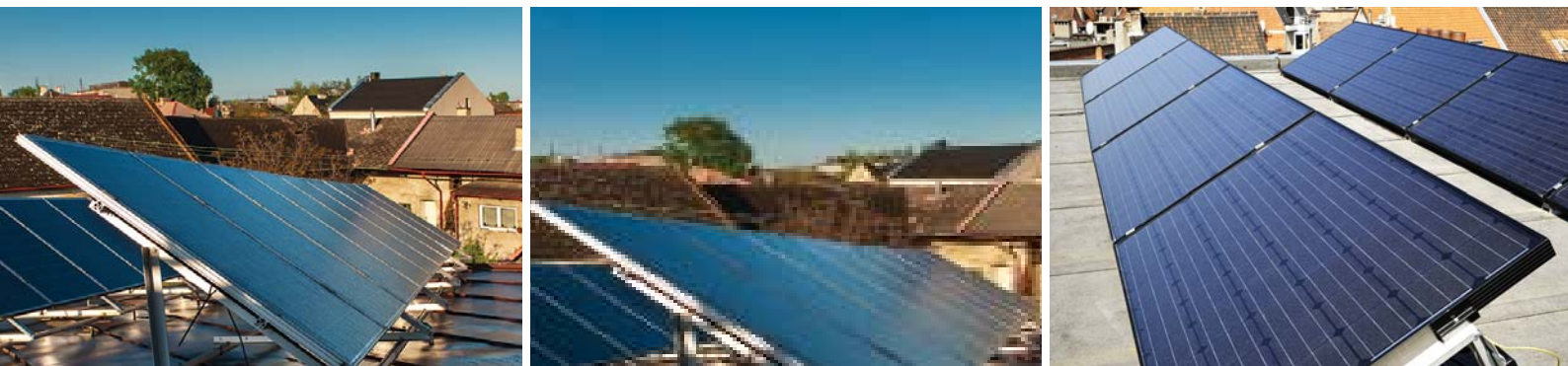
eVillage combina telhados particulares com uma área foto voltaica centralizada para otimizar o espaço solar
